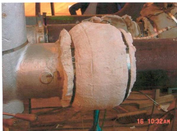
Detalle de la resistencia de aislamiento.
